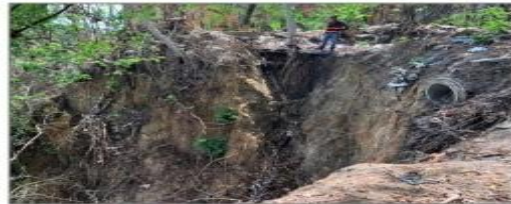
Figura 21 – Foto da cabeceira da voçoroca mostrando o bueiro existente no local. UTM 24 L E702355/N8819096, 11/01/2019.
