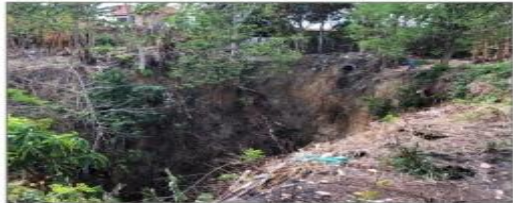
Figura 22 – Vista geral da cabeceira da voçoroca e residências existentes a montante. UTM 24 L E623684/N8731483, 11/01/2019.
