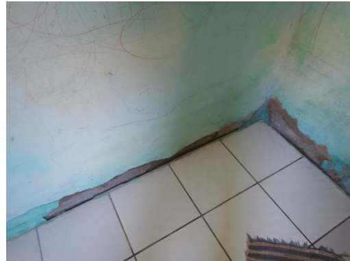
Figura 4 – Residência com várias trincas em pisos e paredes
